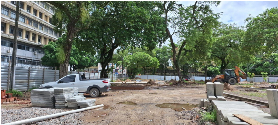
Figuras 3 e 4 – Construção da base de concreto para a colocação de Foodtruck/Container .
