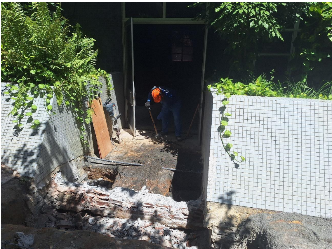
Demolição manual da viga em concreto armado após reforço estrutural na viga existente
