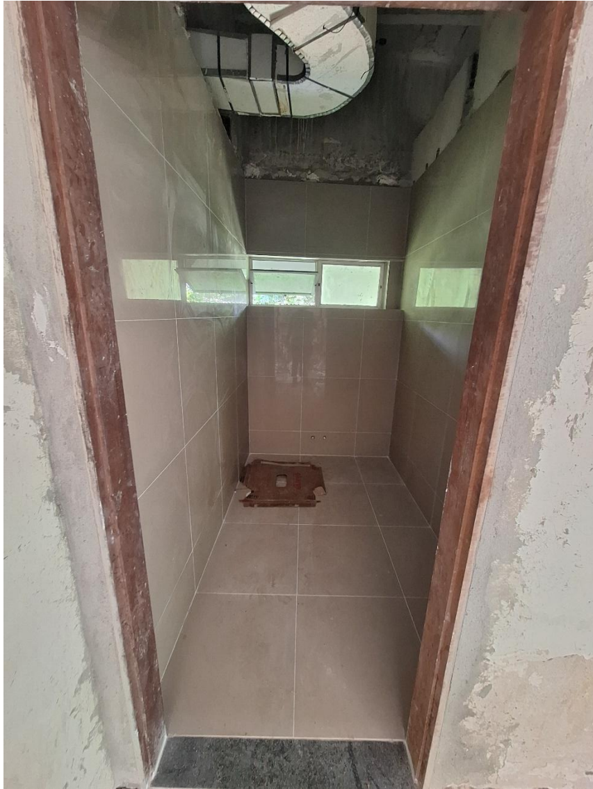
Revestimento cerâmico tipo porcelanato em sanitário do auditório
