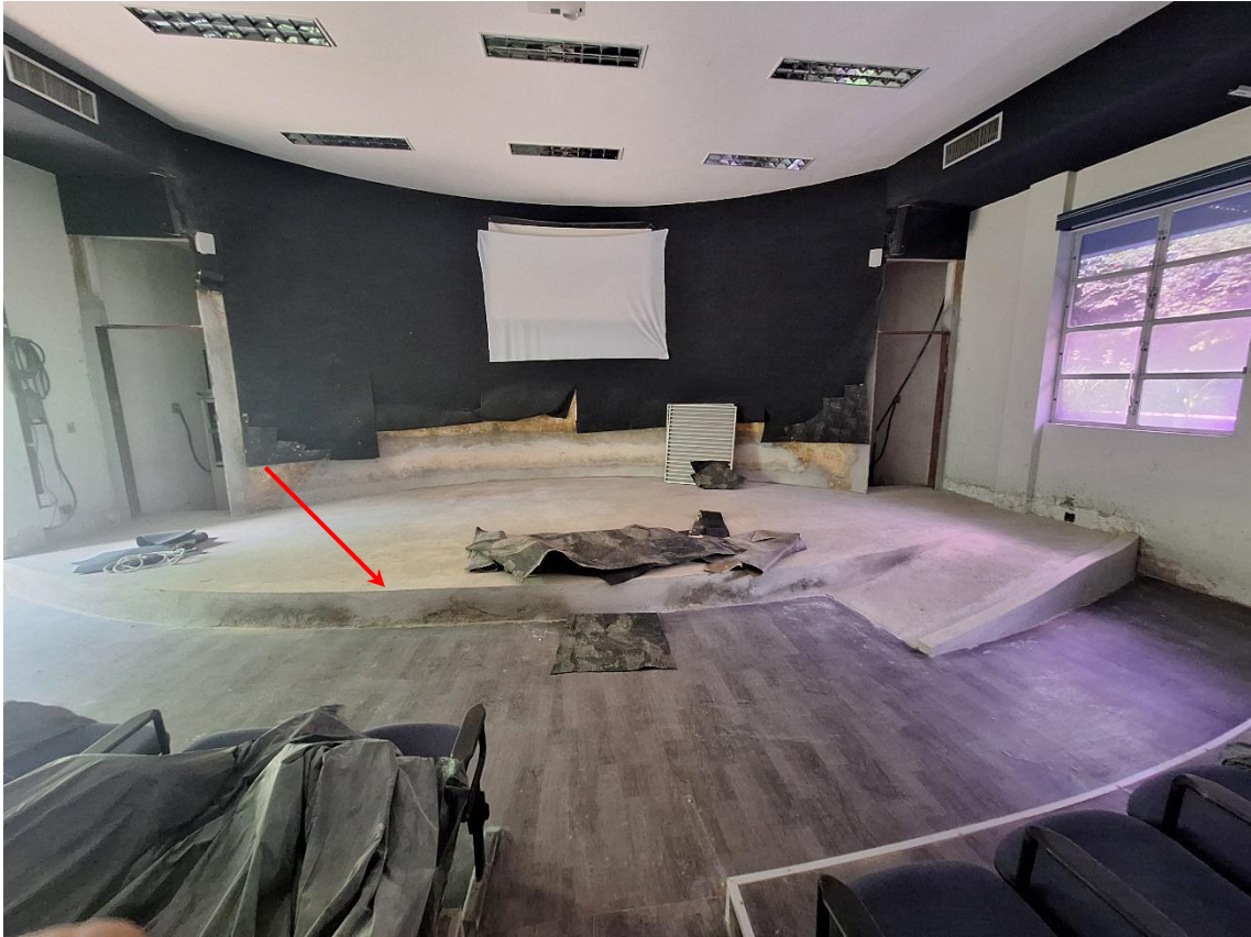
Piso do palco em cimentado para recebimento de piso vinílico do auditório concluído
