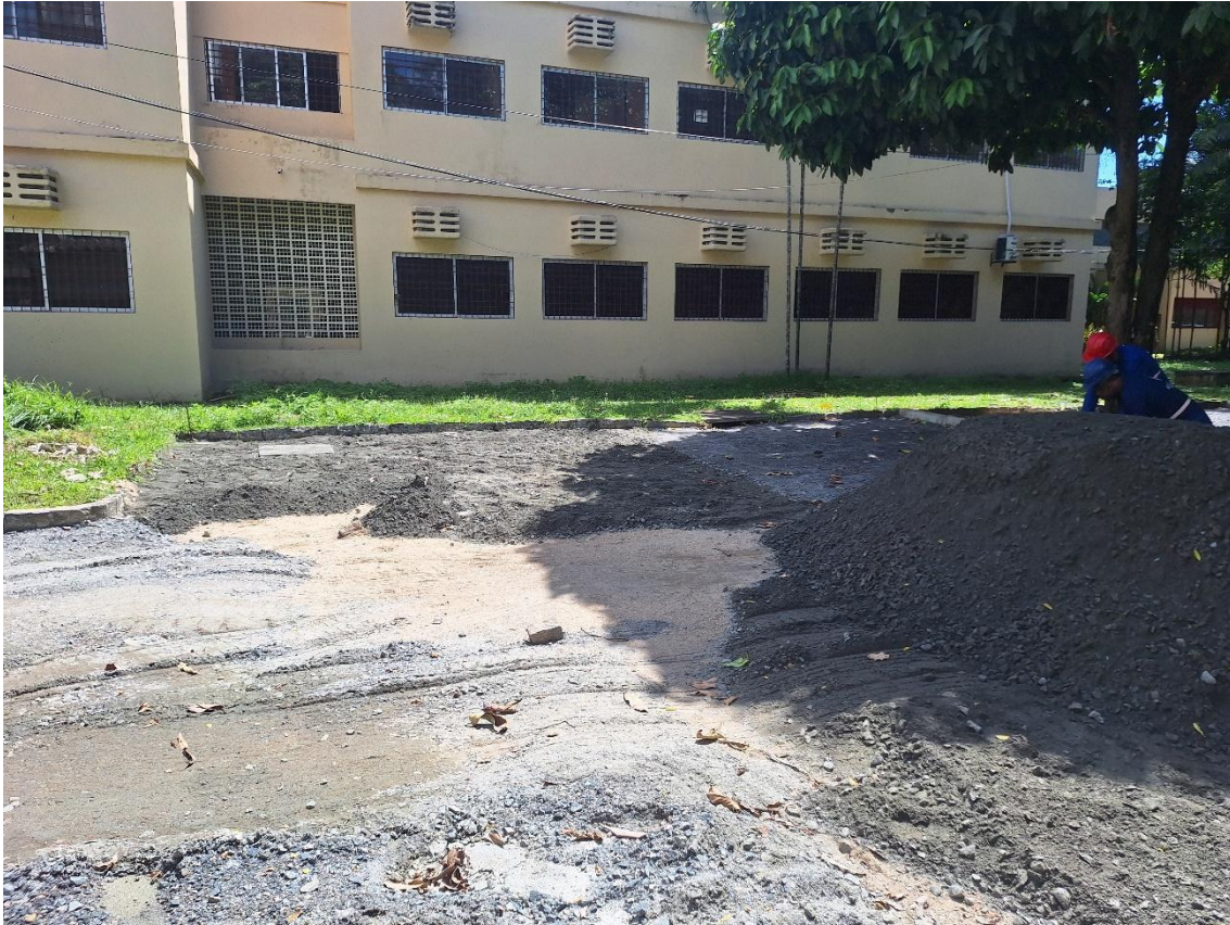
Execução e compactação de base e ou sub-base para pavimentação de brita graduada simples
