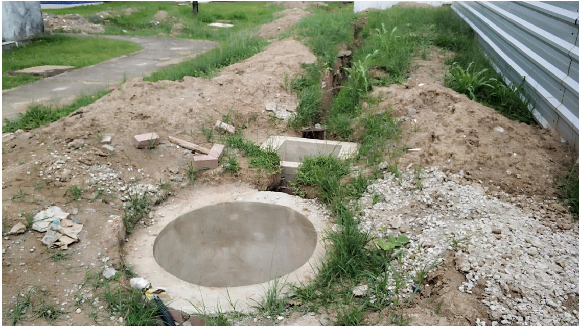
Foto 3: Escavação para instalação das tubulações e construção da caixa para instalação das novas estações elevatórias
