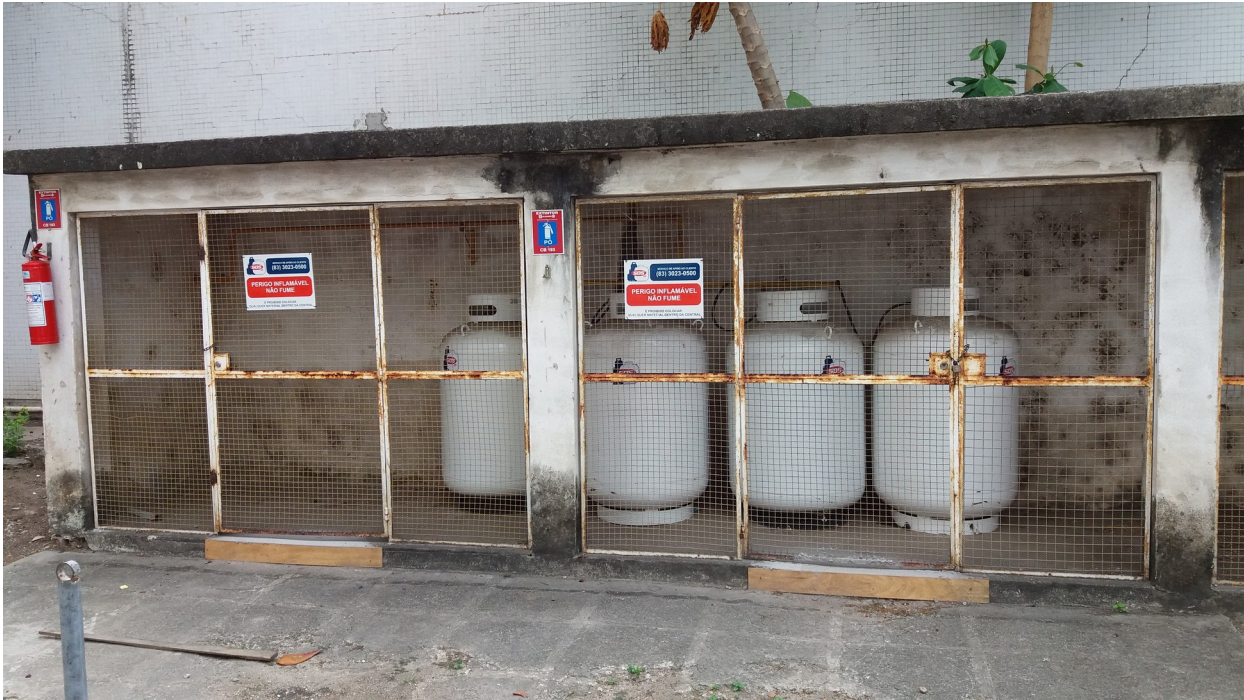
Figura 1: Central de gás GLP
